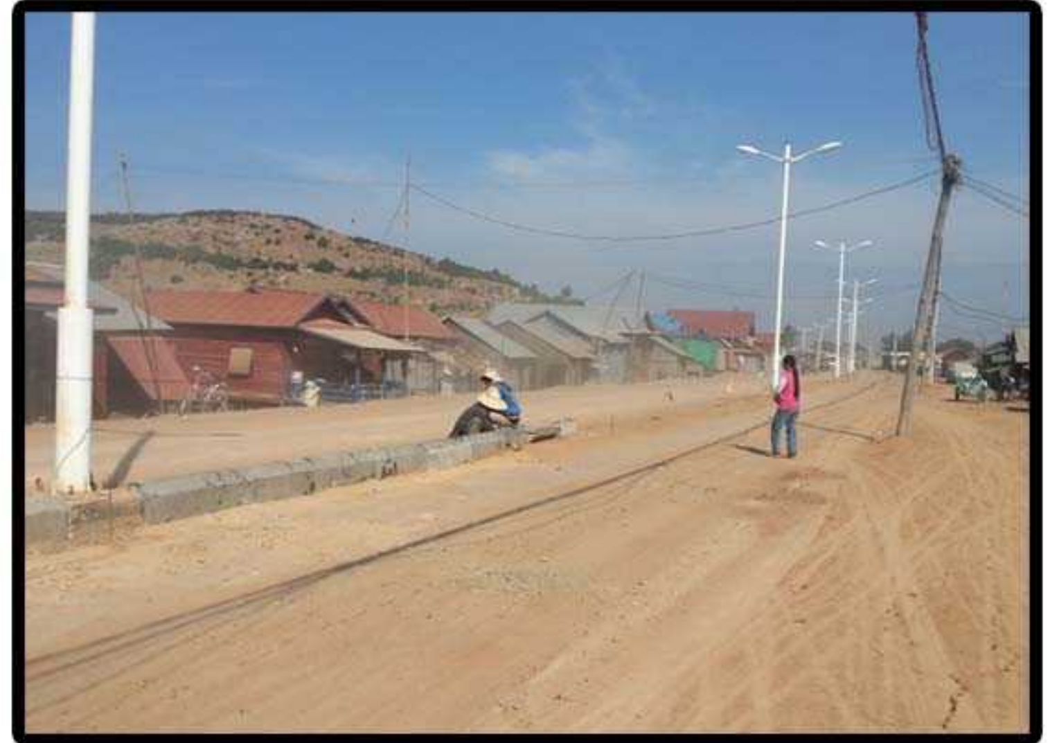
→ 쭉크니어 길목에 설치되는 가로등
